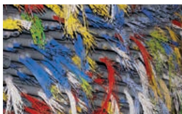
Kabel in großer Vielfalt
