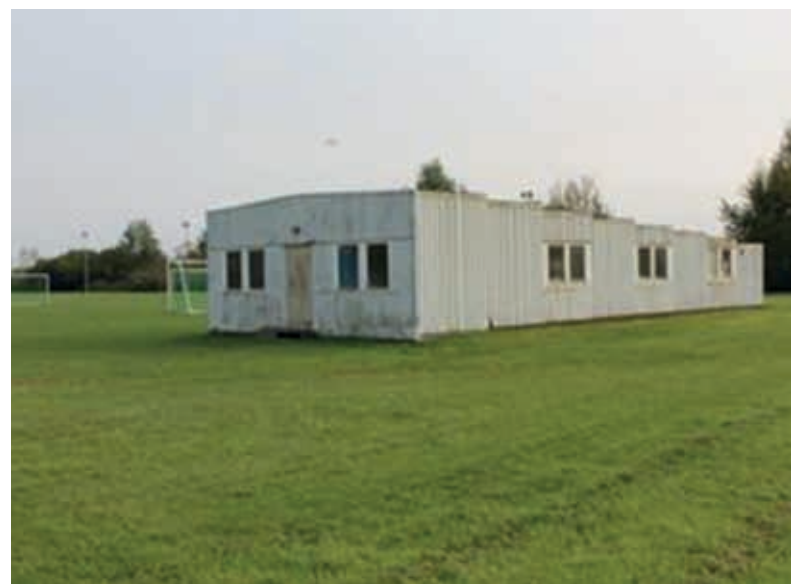
Dieser unansehnliche Containerbau an der sonst sehr gepflegten Sportanlage in Upahl, soll durch ein neues funktionales Mehrzweckgebäude für alle Generationen der ländlichen Gemeinschaft der Gemeinde, ersetzt werden. Foto: Erich Reppenhagen
