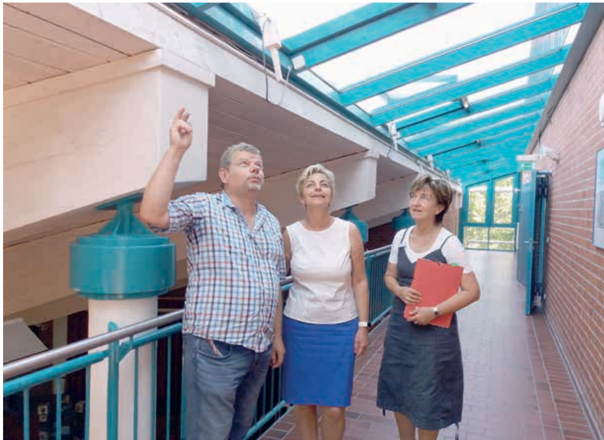
Landrätin Kerstin Weiss (m.), Gudrun Sturmheit, Fachdienstleiterin Bildung und Kultur sowie Jürgen Koop, Hausmeister am Grevesmühlener Gymnasium betrachten das Glasdach des Atriums, das komplett erneuert wird.
