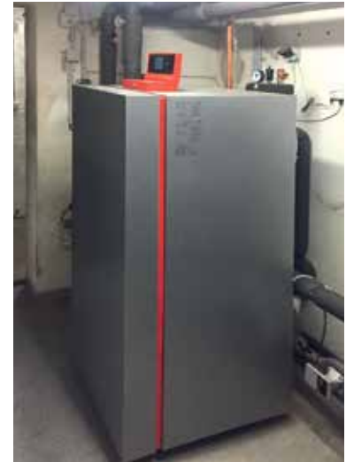
Moderne Heizsysteme als Komplett-paket
